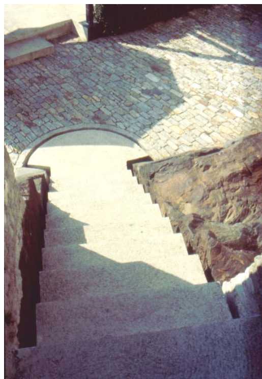
I.10. Detal odwodnienia schodów, prowadzących do zewnętrznej winiarni w zamku Castelgrande. Źródło: fot. autora
