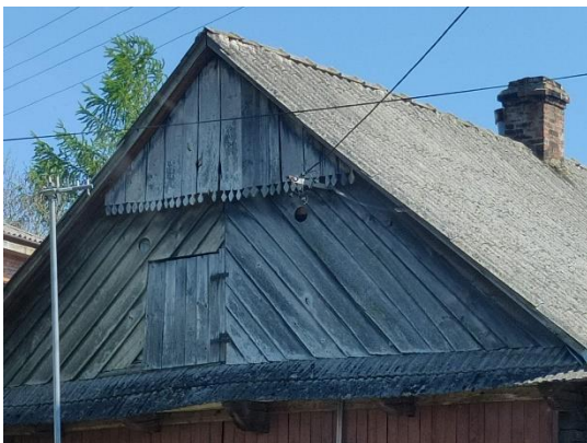
Fig. 4. Boards laid parallel to the roof, ornament on boards in the gable, house in Ropczyce; Subcarpathia, Poland; Source: author's photo Ryc. 4. Deski układane równoległe do połaci dachu, ornament na deskach w szczycie, dom w Ropczycach; woj. Podkarpackie, Polska; Źródło: Fot. Autora
